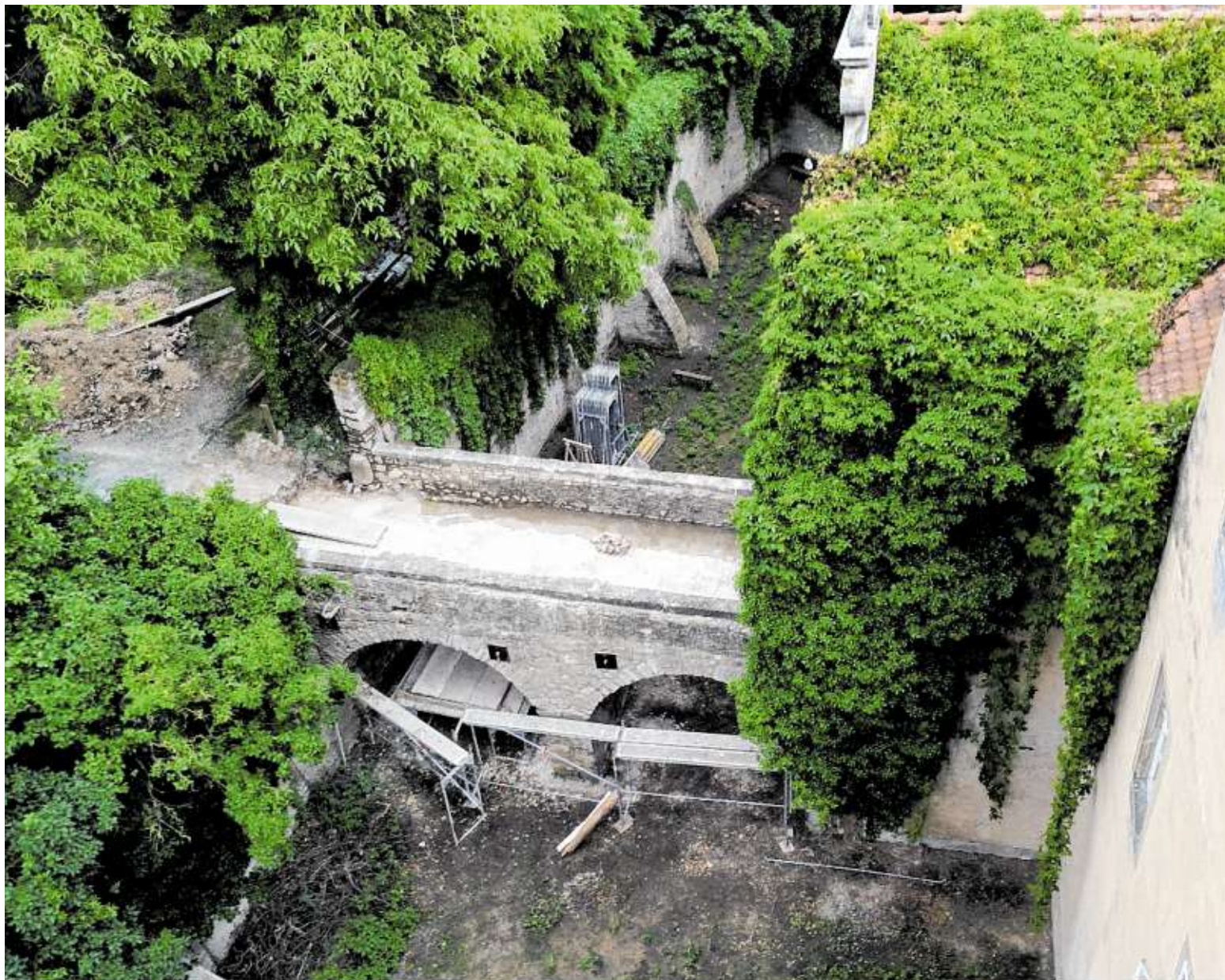
Eingerüstet: Die steinerne Brücke, die Hauptzufahrt ins Zobelschloss, hat Risse und muss erneuert werden.
